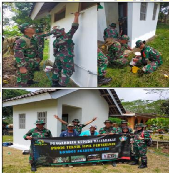
Gambar 7. Pelaksanaan Pekerjaan Pengecatan Pos Pengamanan oleh Dosen dan Taruna Akmil Prodi Teknik Sipil Pertahanan bersama Warga Setempat (Data Primer PKM Prodi Nik Sipil Han, 2022)
