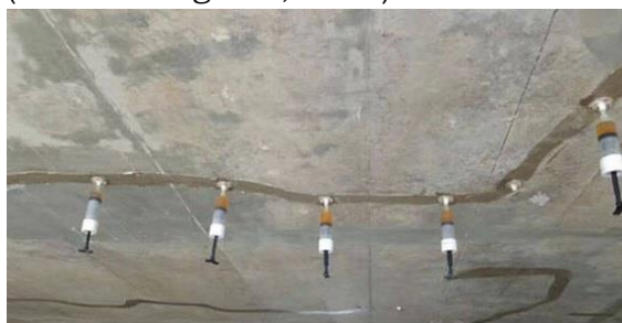
Gambar 2. Metode Injeksi pada Keretakan Struktur Beton Bertulang (Sumber: Kristanto dkk, 2023)
