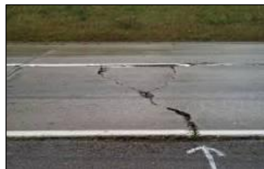
Gambar 1. Retakan pada Jalan (Olahan Penulis, 2024)
