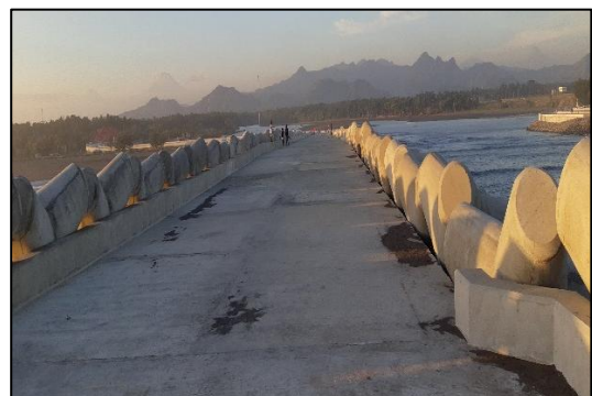
Gambar 3. Infrastruktur pengendali banjir di Muara Sungai Bogowonto (Sumber: Data primer, 2023)
