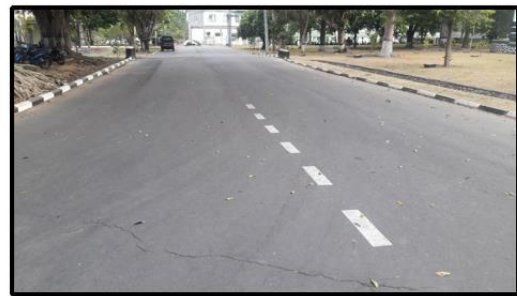
Gambar 6. Kerusakan Retak Memanjang/Melintang Zona/ruas Jalan No. 2 (Sumber: Survey Lapangan, 2024)
