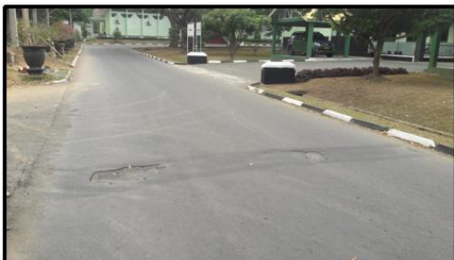
Gambar 10. Kerusakan Lubang Zona/ruas Jalan No. 3 (Sumber: Survey Lapangan, 2024)
