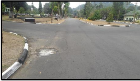
Gambar 9. Kerusakan Lubang Zona/ruas Jalan No. 18 (Sumber: Survey Lapangan, 2024)
