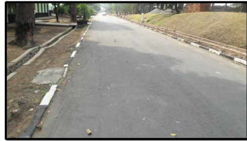
Gambar 5. Retak Memanjang/Melintang Zona/ruas Jalan No. 9 (Sumber: Survey Lapangan, 2024)
