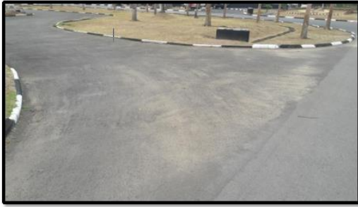
Gambar 8. Kerusakan Pelepasan Butir Zona/ruas Jalan No. 18 (Sumber: Survey Lapangan, 2024)
