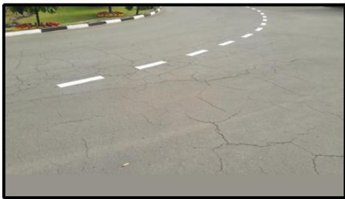
Gambar 3. Kerusakan Retak Buaya Zona/ruas Jalan No. 11 (Sumber: Survey Lapangan, 2024)
