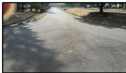
Gambar 7. Kerusakan Pelepasan Butir Zona/ruas Jalan No. 8 (Sumber: Survey Lapangan, 2024)
